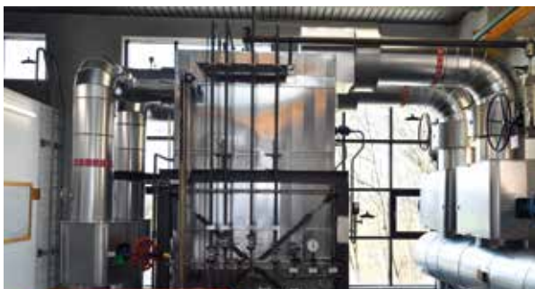
Heizkondensator in einem Heizkraftwerk heat condenser in a power station
