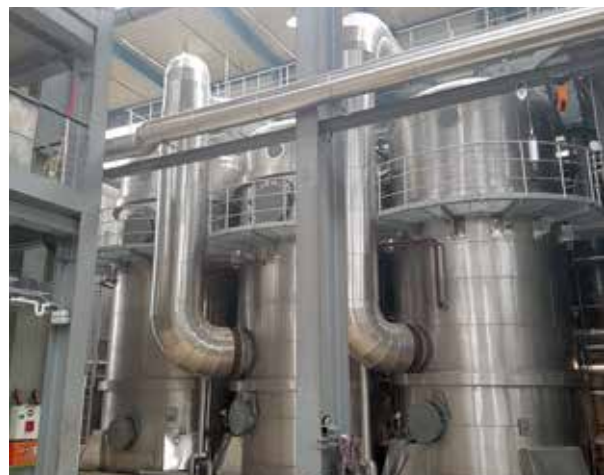
Plattenverdampfer in einer Zuckerfabrik plate evaporator in sugar factory
