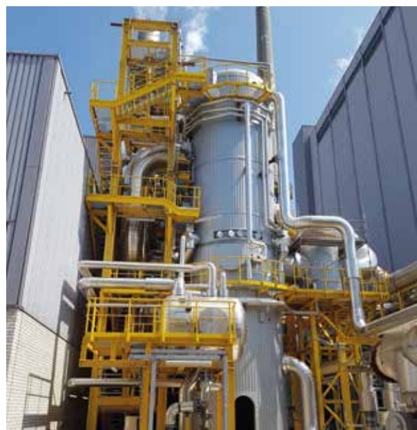
Plattenverdampfer in einer Zuckerfabrik plate evaporator in sugar factory
